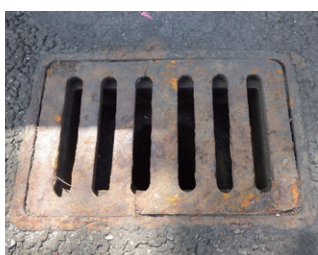
錆により腐食した柵蓋(橋梁用)
