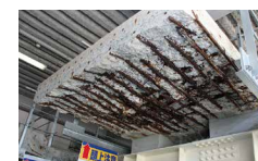
床版下面の剥落
