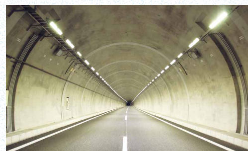
トンネルLED灯
