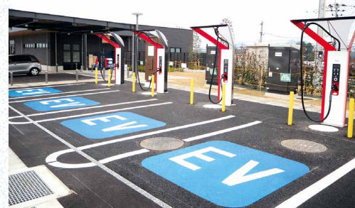
急速充電設備
