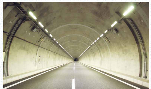
トンネルLED灯
