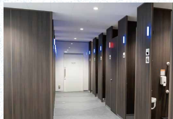
空きブースが目でわかるランプ （九州道 北熊本SA（上））
