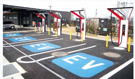
急速充電設備
