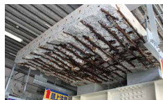
床版下面の剥落
