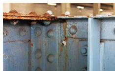
鋼材の疲労亀裂
