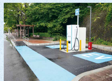
EV急速充電設備(高松道 豊浜SA(下))
