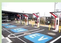
EV急速充電設備整備
