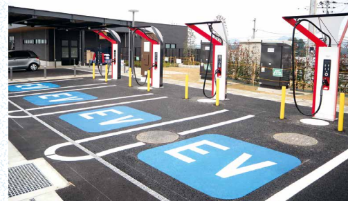
急速充電設備
