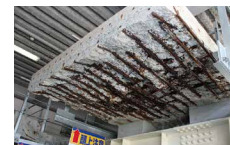
床版下面の剥落
