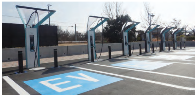
急速充電設備
