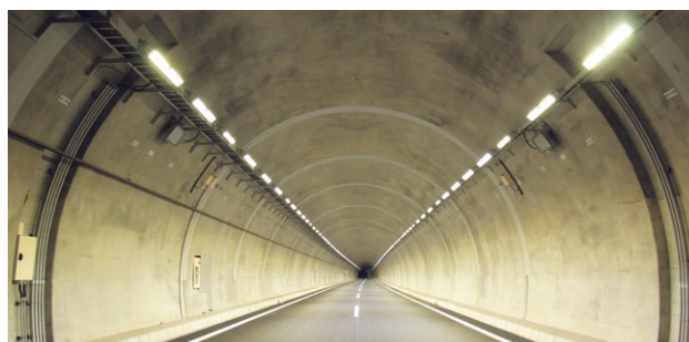
トンネルLED灯
