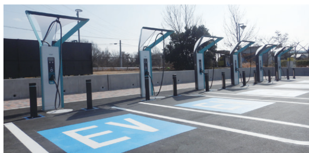
急速充電設備
