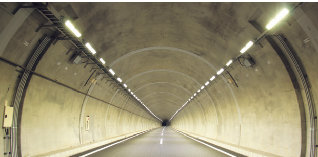
トンネルLED灯
