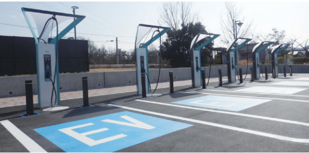
急速充電設備
