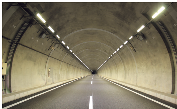
トンネルLED灯
