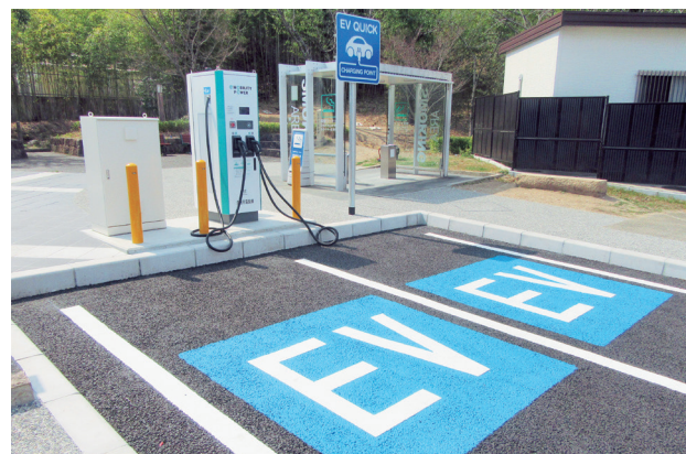
急速充電設備
