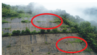
① 切土のり面上部の変状 /長崎道(東脊振IC~佐賀大和IC)(上)
