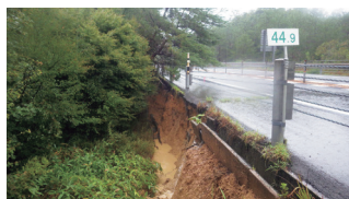
② 盛土のり面表層滑り /浜田道(旭IC~浜田JCT)(上)
