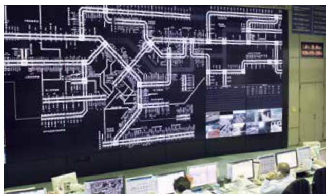
道路管制センター
