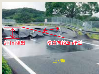
路面の被害状況
