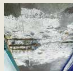
橋梁下面の損傷状況
