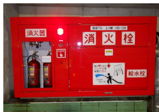
《更新後の消火栓》
