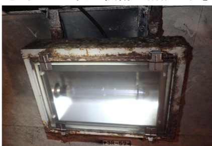
《トンネル照明の緊急補修（補修前）》
