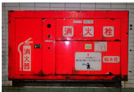
《従前の消火栓》
