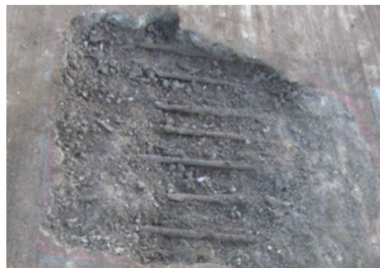
《床版上面のコンクリート土砂化》
