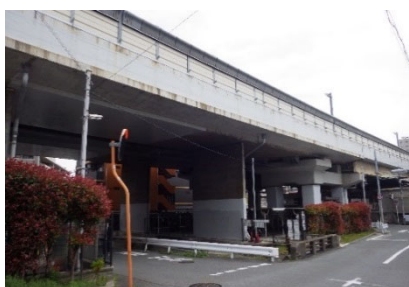
《橋梁上部工はく落対策（補修前）》
