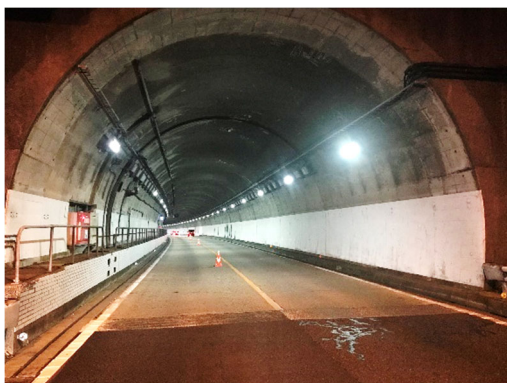
《トンネル照明のLED化》
