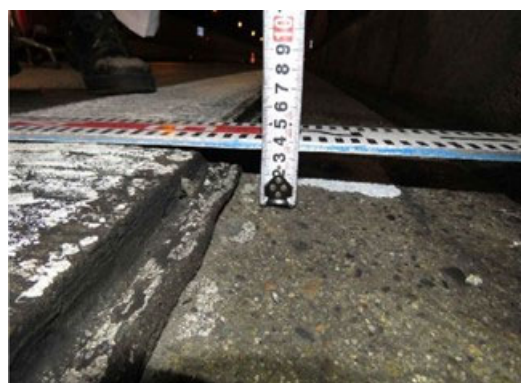
《トンネル路面隆起による段差》
