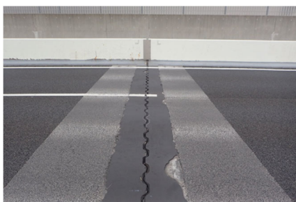
《伸縮装置の損傷（補修前）》
