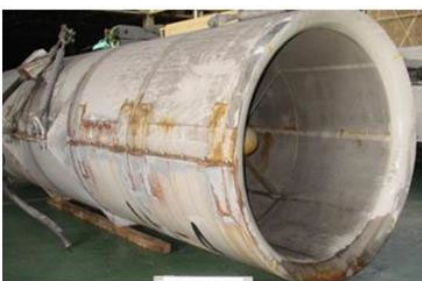
《トンネルジェットファン（補修前）》
