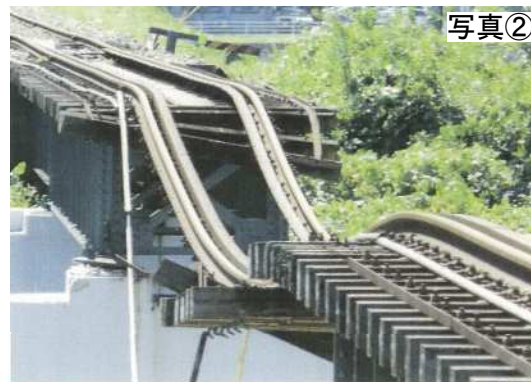
信楽高原鉄道落橋 (杣川橋上流)
