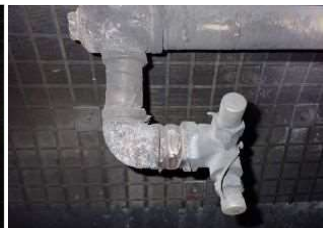
水噴霧設備 (設置から25年経過)
