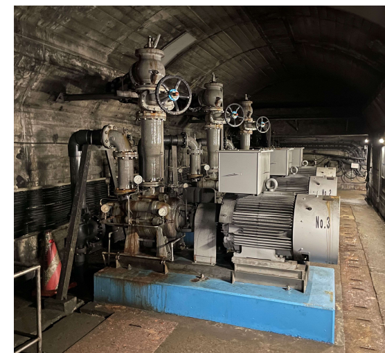
排水ポンプ (設置から14～30年経過)
