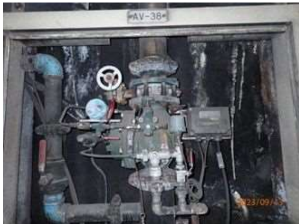
【非常用設備更新】
