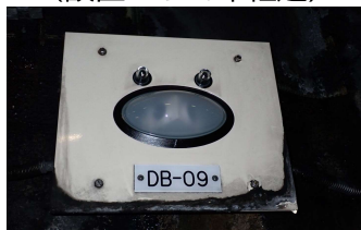
火災検知器 (設置から11年経過)
