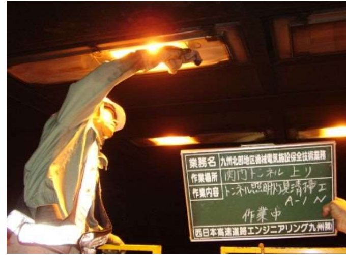
【トンネル照明設備】
