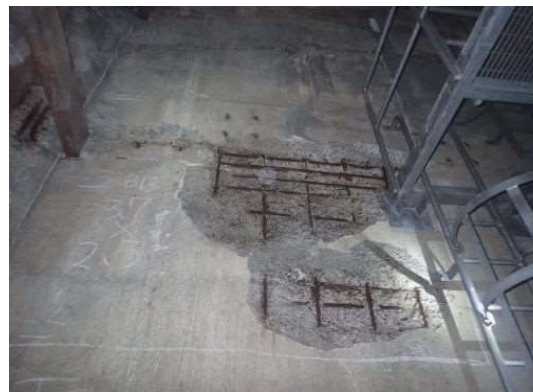
鉄筋露出状況
