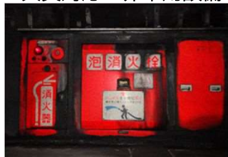
消火栓 (設置から26年経過)
