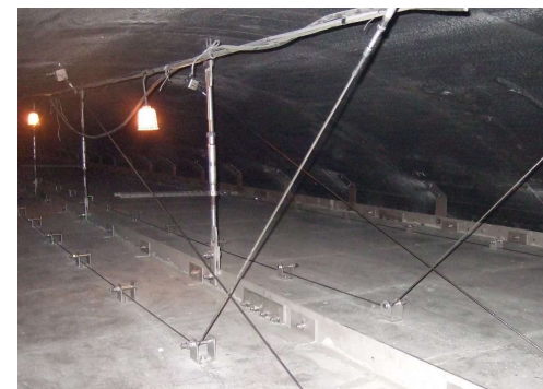
フェールセーフ設置状況
