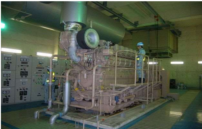
【非常用発電設備】
