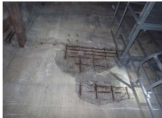
鉄筋露出状況
