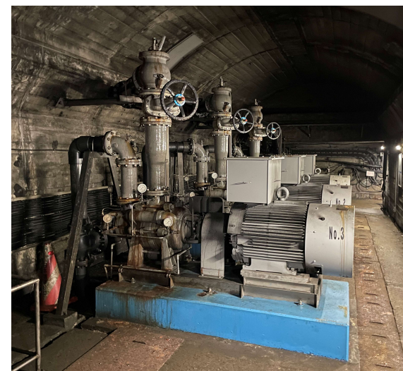
排水ポンプ (設置から14～30年経過)
