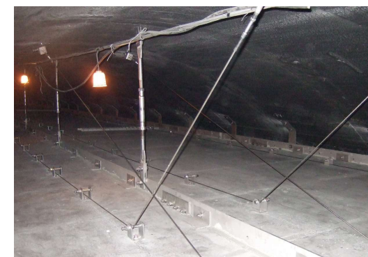
フェールセーフ設置状況
