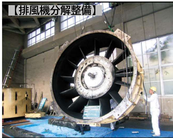
整備頻度 (1回/5年) 計12基設置
