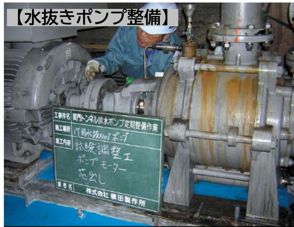
整備頻度 (1回/10年) 計17台設置
