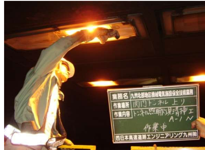
【トンネル照明設備】
