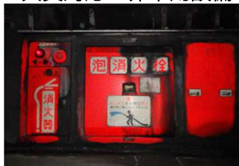
消火栓 (設置から26年経過)
