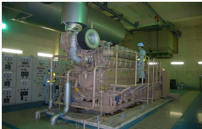
【非常用発電設備】
