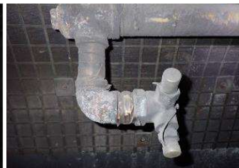
水噴霧設備 (設置から25年経過)
