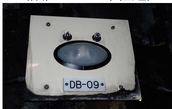
火災検知器 (設置から11年経過)
