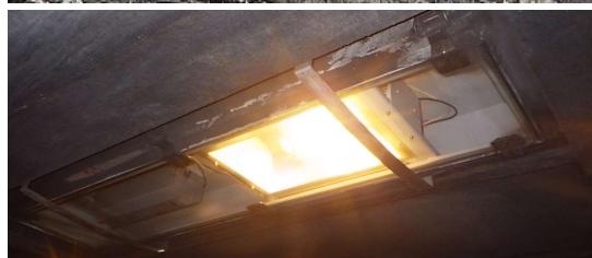
照明設備 (設置から22年経過)
