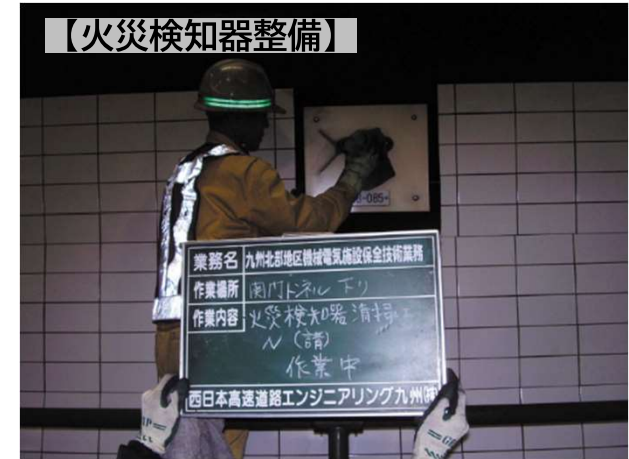
整備頻度 (1回/6年) 計140台設置
