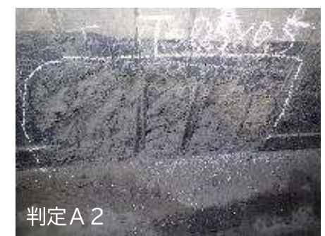
④ S 7 区間 下壁の鉄筋露出
