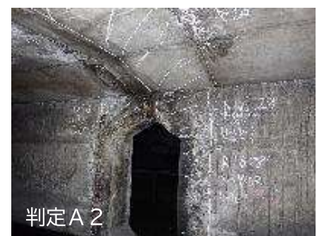
③ S 6 区間 下壁のはく離（浮き）
