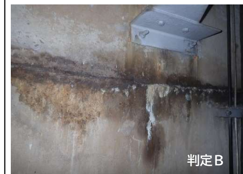
No. 12位置壁面のエフロレッセンス
