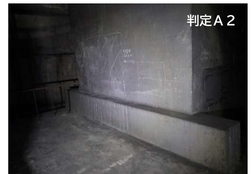
B 12 階送気ダクト壁面にはく離
