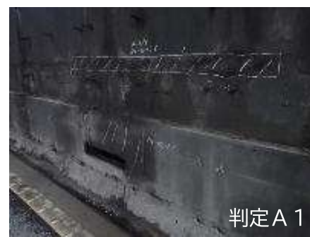
③ S8区間 側壁部のはく離（浮き）
