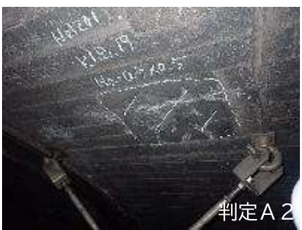
① S6区間 覆工部のはく離（浮き）
