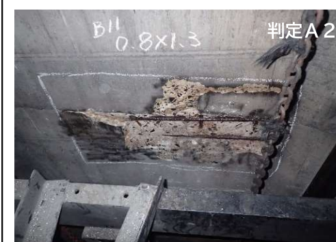
B 11階エレベーターシャフト壁面に鉄筋露出
