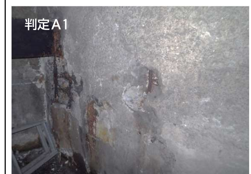
B 14階エレベーターシャフト壁面にはく離
