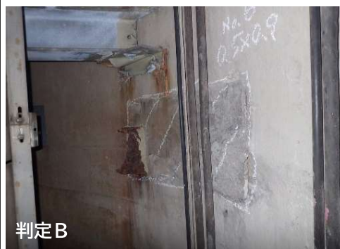
No. 8位置壁面のはく離
