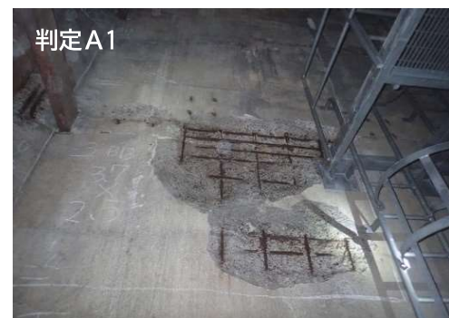
B 13階エレベーターシャフト壁面に鉄筋露出
