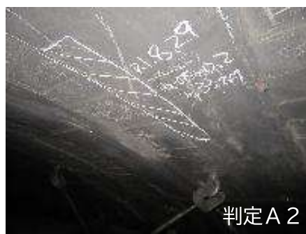
② S1区間 覆工部のはく離（浮き）
