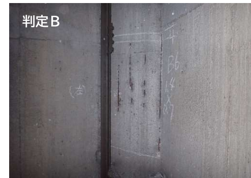
B 6階エレベーターシャフト壁面に鉄筋露出
