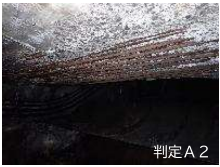
① S 6 区間 床版下面の鉄筋露出 みち、ひと…未来へ。
