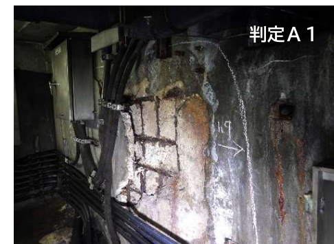
②位置の門司立坑連絡坑に鉄筋露出 (機械室 (ポンプ) の壁面)
