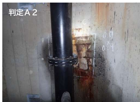
No. 5位置壁面のはく離(鉄筋露出)
