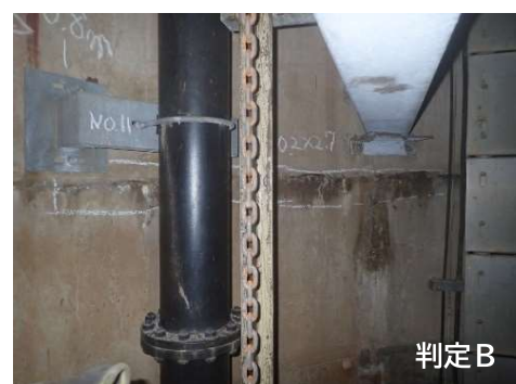
No. 11位置壁面のエフロレッセンス
