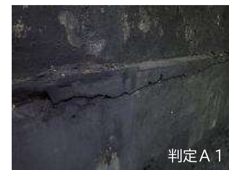
④ S3区間 側壁部のはく離（浮き）
