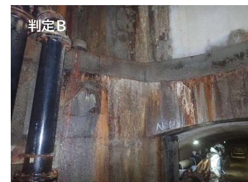
No. 11位置壁面エフロレッセンス
