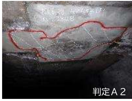
② S 6 区間 床版下面のはく離（浮き）
