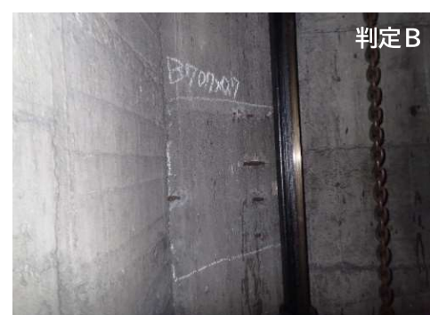
B 7階エレベーターシャフト壁面にはく離
