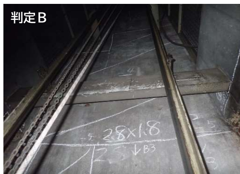
B 2 階エレベーターシャフト壁面に浮き
