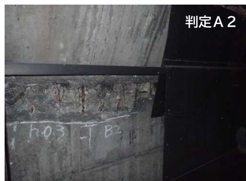
B 2階エレベーターシャフト壁面に鉄筋露出
