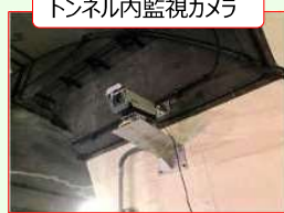
トンネル内監視カメラ
